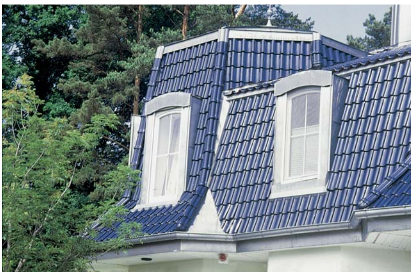
Die Einteilung der Hohlfalzziegel musste bei der Kleinteiligkeit der Dachflächen sorgfältig geplant werden.
