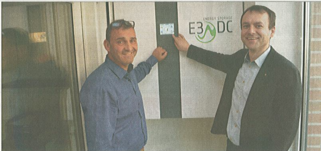
„Wir sind jetzt Energieerzeuger“, freut sich Beste Bau-Geschäftsführer Dirk Berkefeld (li., hier an dem in seinem Büro installierten Speicher für den Solarstrom) über die mit Energy Consultant Eckhard Mai verwirklichte Energieanlagenkombination für Strom- und Wärmeerzeugung. Foto: Walter Klinger
